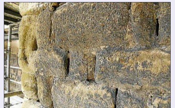
La pedra de la base està ennegrida pels cotxes
