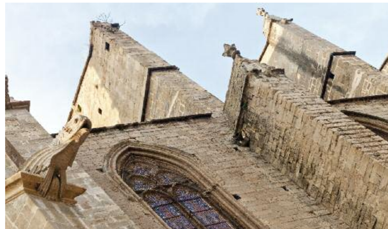
Una part de la façana sud, en mal estat i pendent de restauració. En aquesta façana hi ha el vitrall de la Puríssima, per a la recuperació del qual s'ha engegat una campanya popular de captació de fons, ja que cal actuar-hi de manera urgent.
